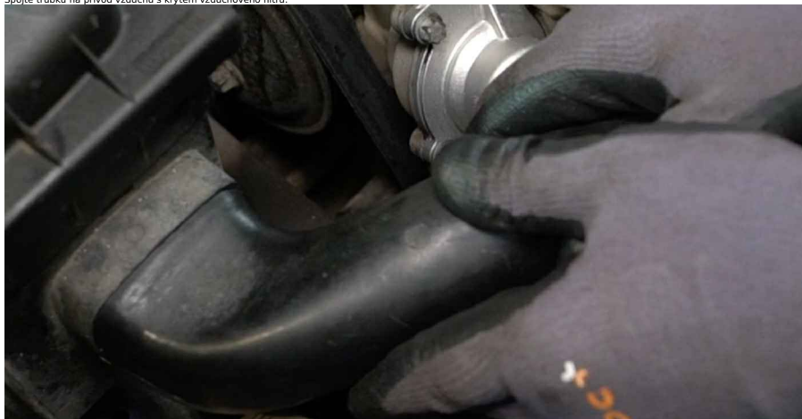
32 Připevněte sponu na sací hadici vzduchového filtru.
